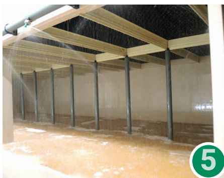
Étape de nettoyage chimique et réservoir
