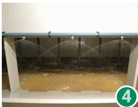
Pré-nettoyage et réservoir
