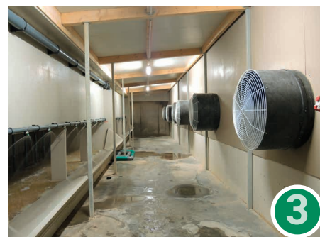
Chambre de compression
